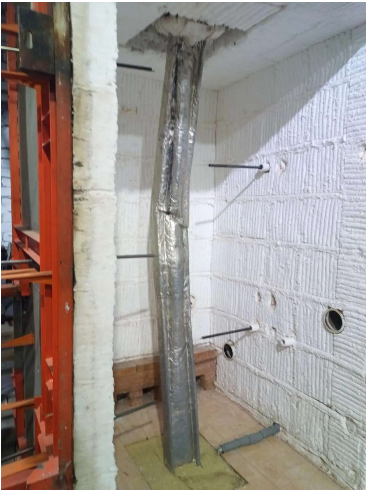
Фото 7 Деформированная колонна после огневых испытаний.
